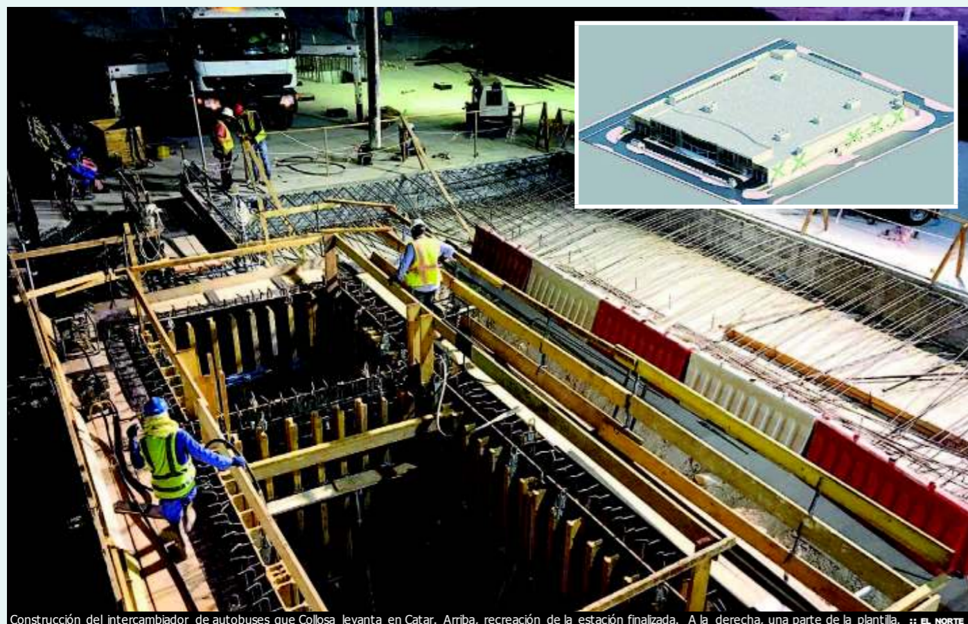
Construcción del intercambiador de autobuses que Collosa levanta en Catar. Arriba, recreación de la estación finalizada. A la derecha, una parte de la plantilla. :: EL NORTE
